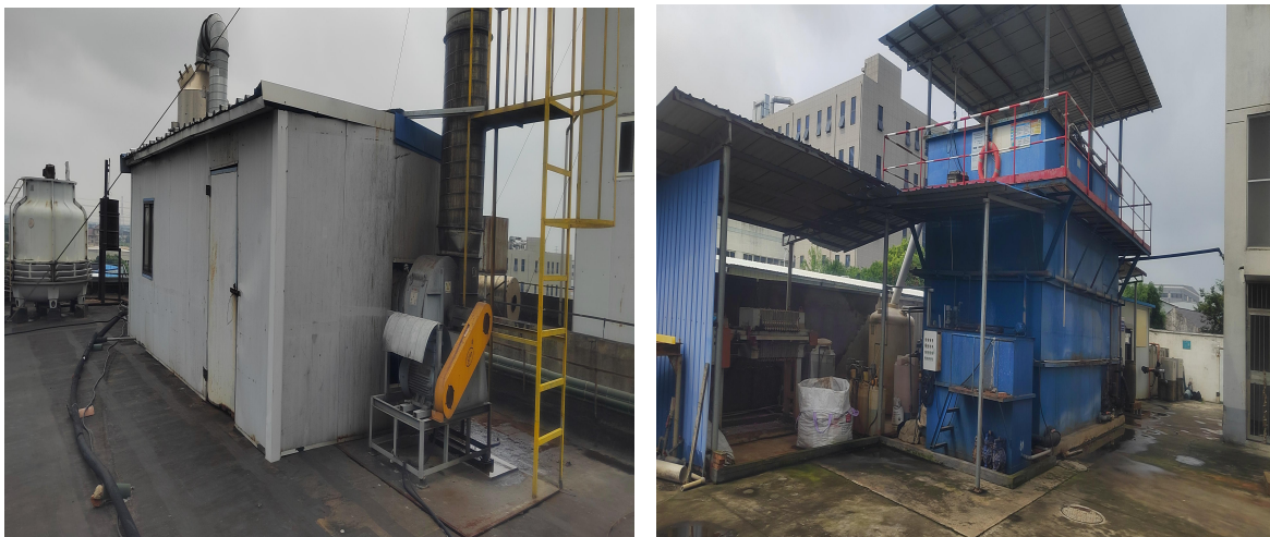
图3 工厂废气、废水处置设施照片
