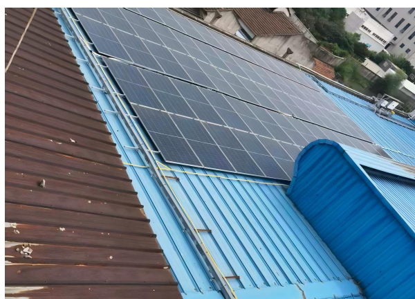
图 7 厂房屋顶光伏照片
