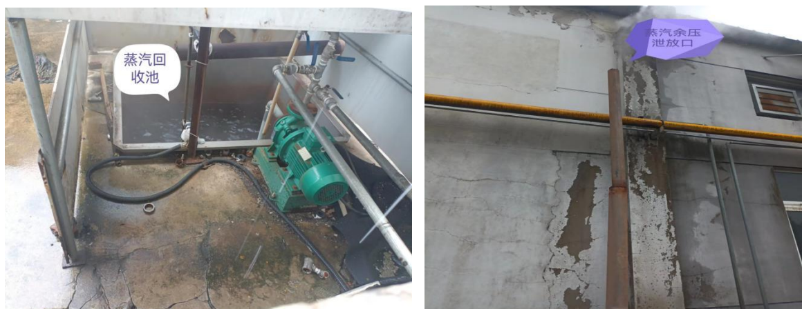
图 5 蒸汽冷凝水回收项目图片
